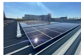
「太陽光発電システム」
